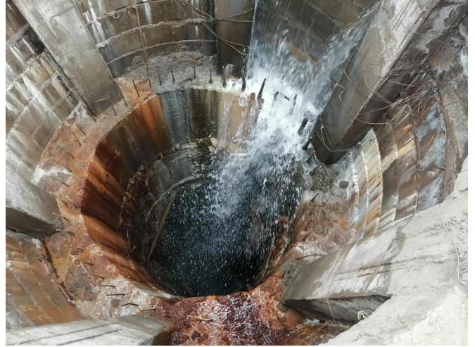
图 3.2.2.1-2 排洪系统排水井
